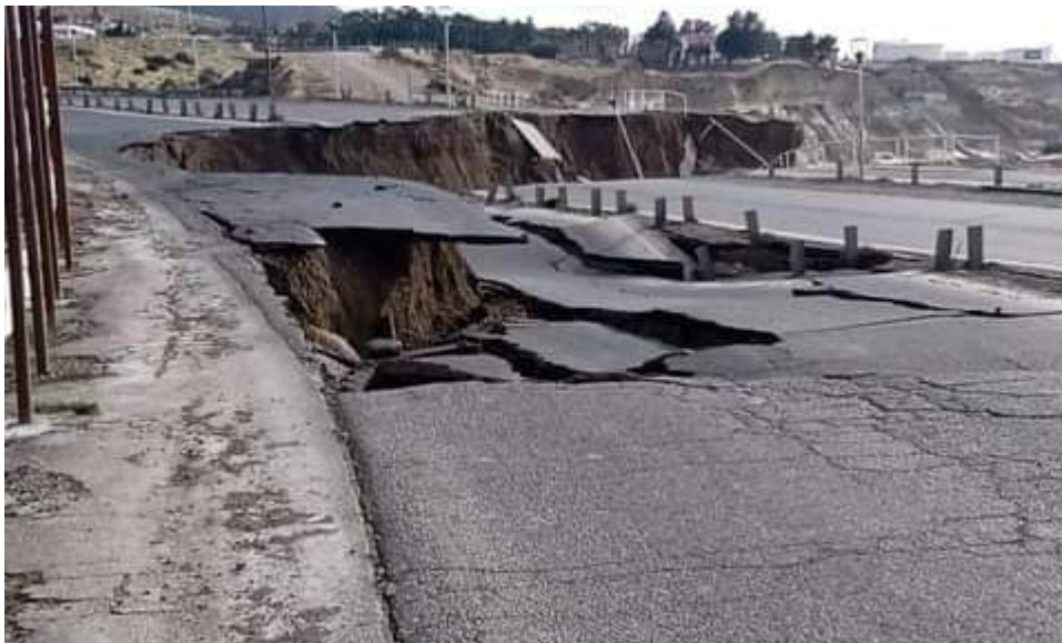
Figura 8. Reactivación del deslizamiento en el Cerro Chenque, RN3 (Agosto, 2023).
