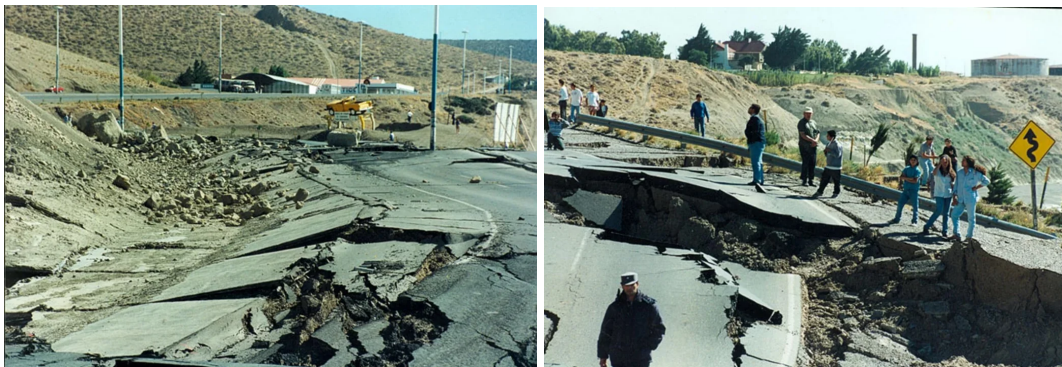
Figura 7. Imágenes del colapso de la Ruta Nacional 3 (febrero de 1995), sector "El Infiernillo". 2026.
